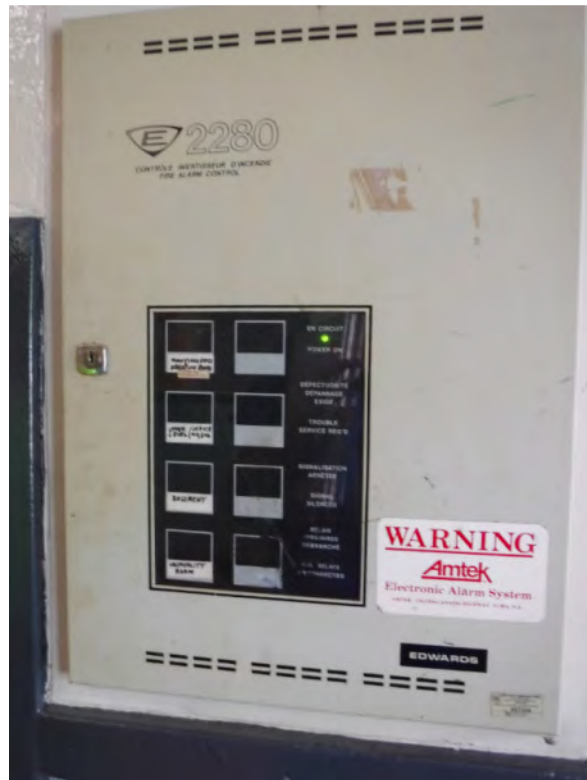
E15: Aging fire alarm panel
